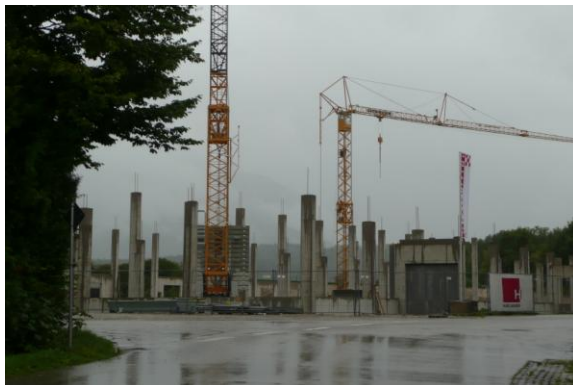
Impressionen vom Bau der künftigen ICS Logistikhalle (ca. 13 m hoch) in Türk im September 2017
